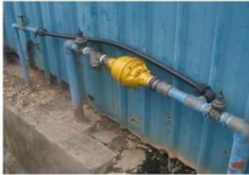
Plat B5: Meter air 2" yang digunakan oleh kilang ATLAS
