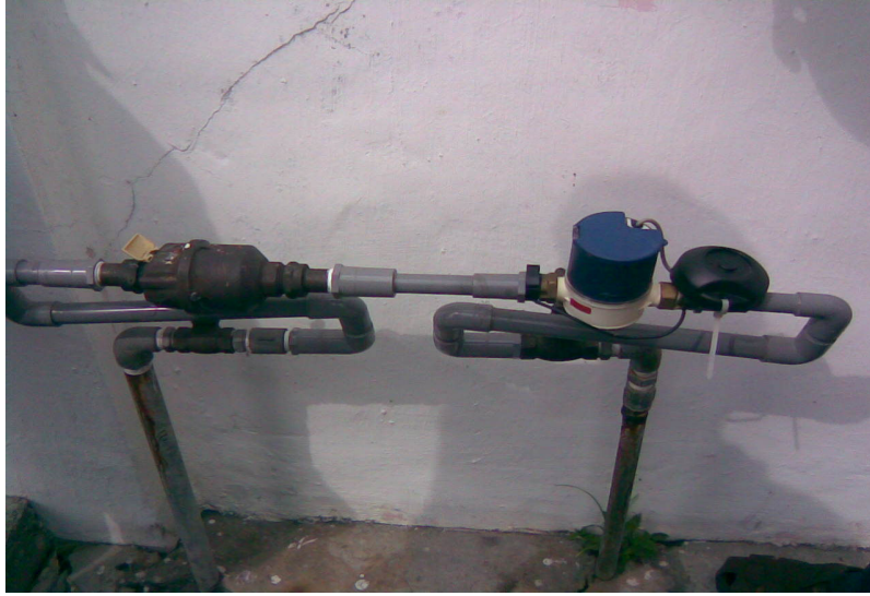
Plat B7: Kedudukan sebenar SmartMeter dan Mechanical Meter
