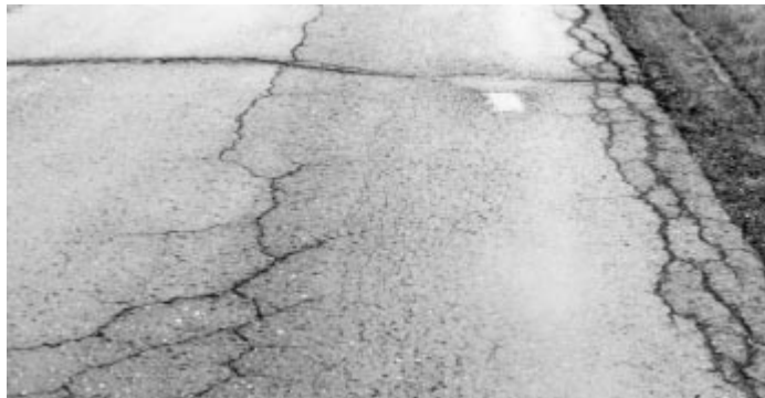
Rajah 2.5: Gambarajah retak pinggir
